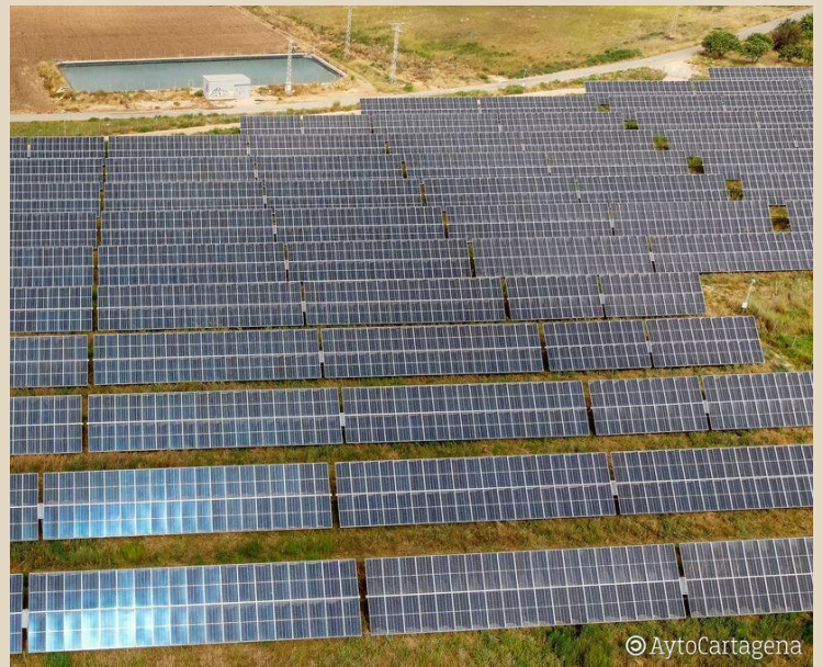
Planta fotovoltaica "La Asomada" en Santa Ana.
